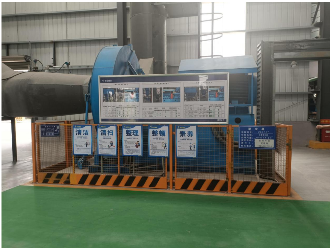
废气除尘装置
